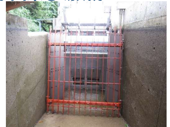
除塵機の手前に粗目スクリーン
