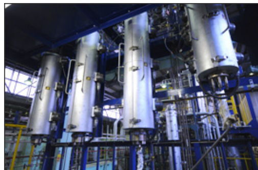
直径30cm、高さ2mの脱硫塔試験機
