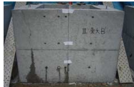
▲自己治癒の実証試験。コンクリート貯水容器にひびを入れ、内部に水を入れて自己治癒の状況を観察する（この写真はひびを入れた直後）
