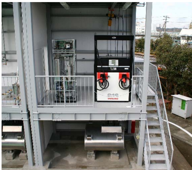
図 A-(6)-8 模擬ガソリンスタンド設備
