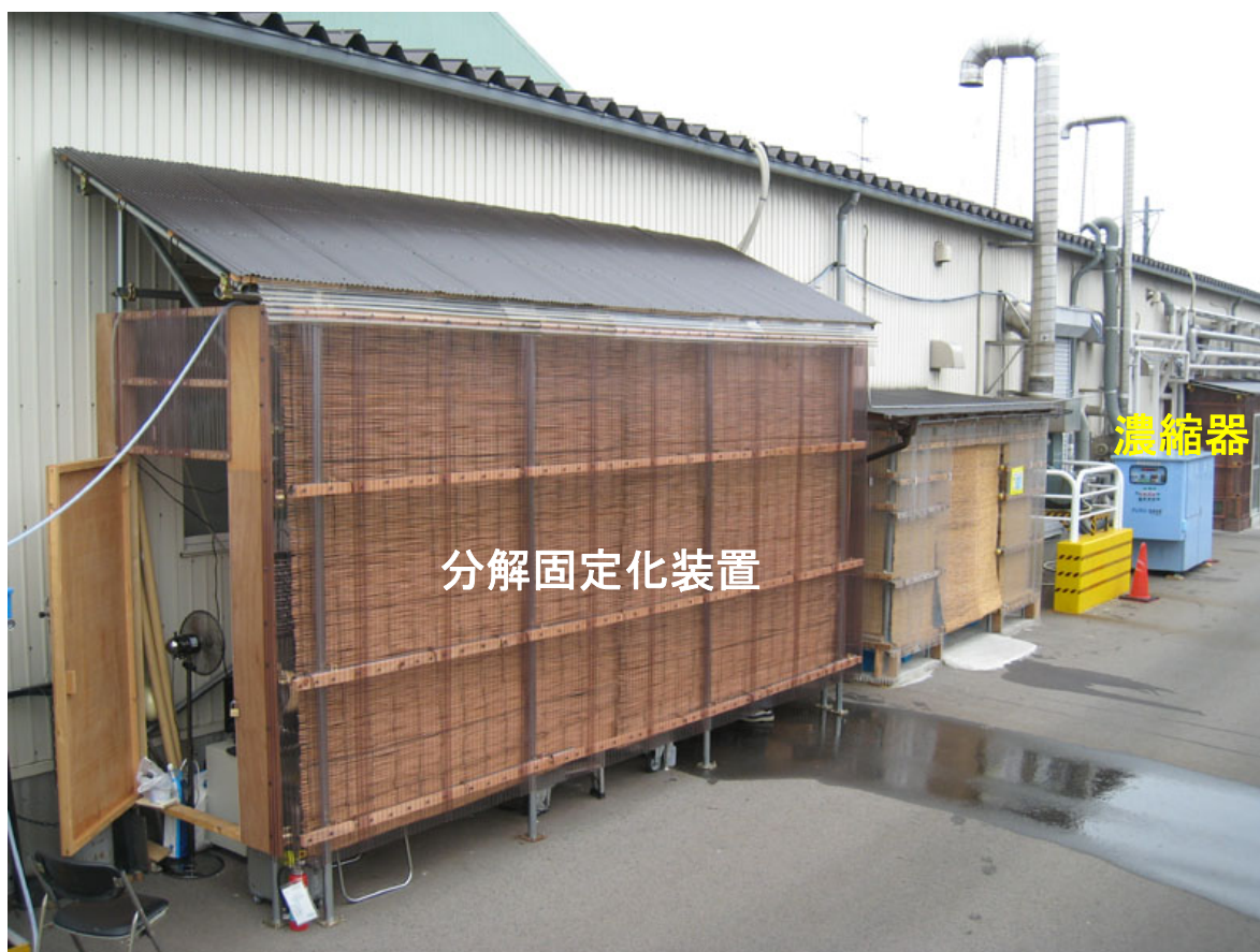
図 A-(7)-3 実証試験設備の全景
