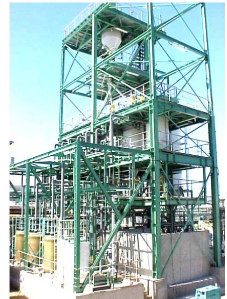
後処理設備 13 (旭硝子(株)鹿島工場)
