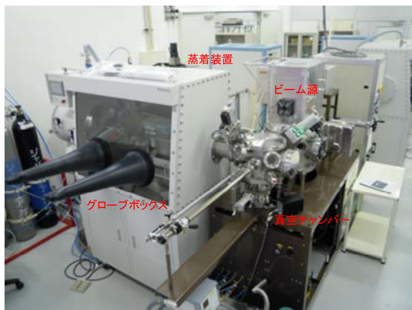
図②-(1)-1.51 設置完了後の装置全体
