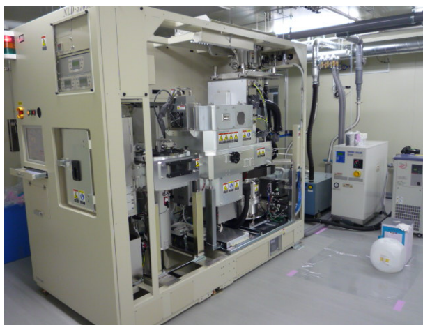
図①-(1A)-1-1.4 エッチング装置外観写真
