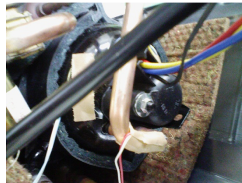
d) 冷媒温度計測点 (圧縮機吹き出し)
