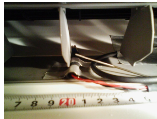
e) 室内機吹き出し温湿度 (左)
