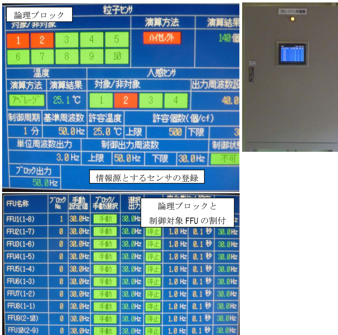
図V.4.1-4 制御盤外観画像と操作パネル画面の一例
