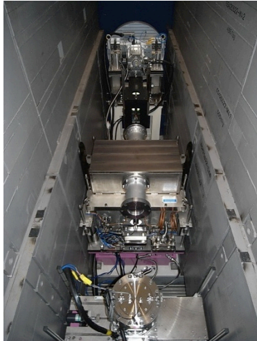
図Ⅲ.2.5.-(9) 設置された NOVA の中性子ビーム整形機器
