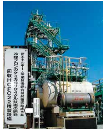
図3 冷却精製設備
