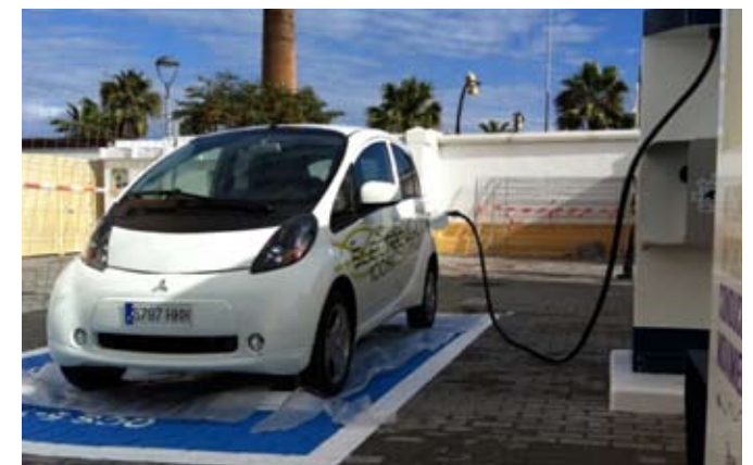
マラガ市に設置される急速充電ステーション
