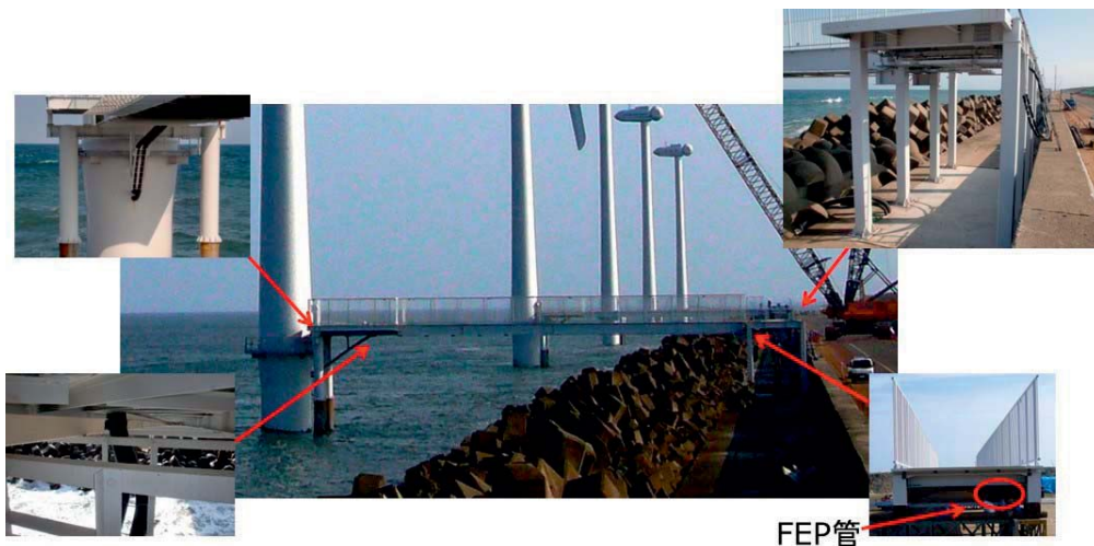
図 3.7.2-91 ウィンド・パワーかみす第1洋上風力発電所の電気設備 (岡野, 2010)
