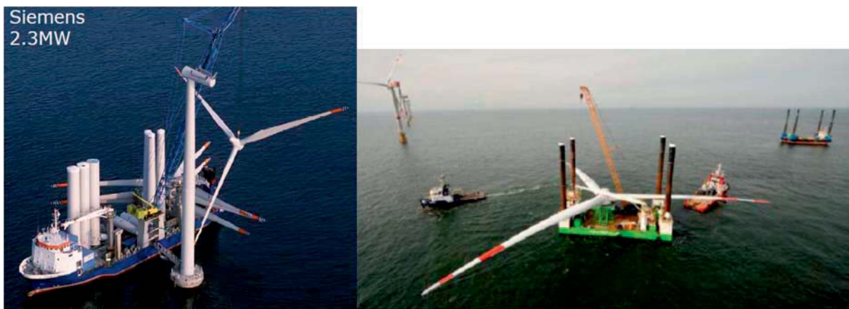
図 3. 7. 2-50 風車 (左図 Siemens2. 3MW/右図 REpower5. 0MW) のナセル設置工事 (Lindvig, 2011)
