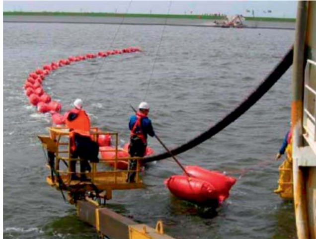
図 3.7.2-83 沿岸部における海底ケーブル敷設状況 (日本産業機械工業会, 2010)
