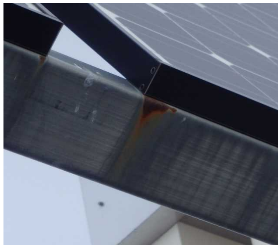
図Ⅲ-2-①-(6)-10 水みち腐食発生事例
