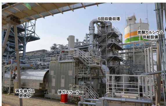
図 3-9 硫黄回収設備
