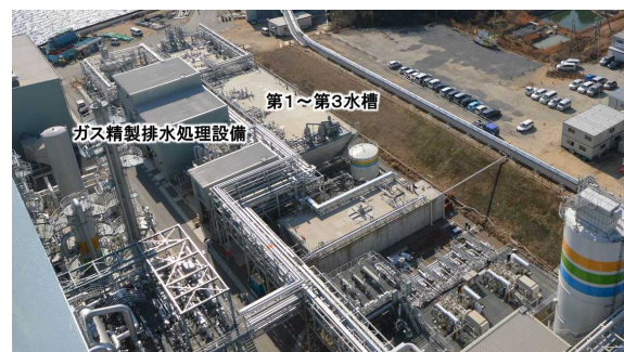
図 3-13 排水処理設備
