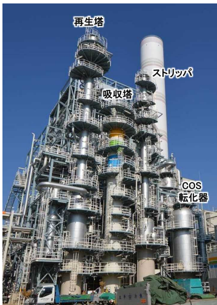
図 3-8 ガス精製設備
