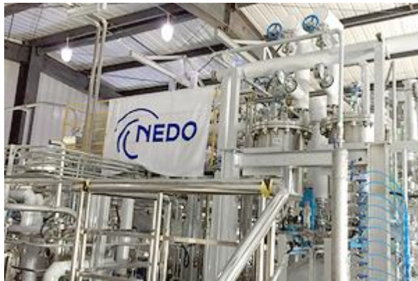
エタノール製造設備
