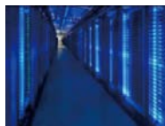
通信市場（データセンター）
