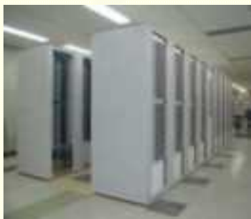
データセンター
