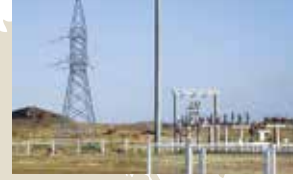
省エネ送電システム(モンゴル)
