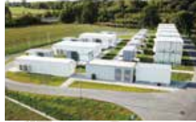
大規模ハイブリッド蓄電池システム(ドイツ)
