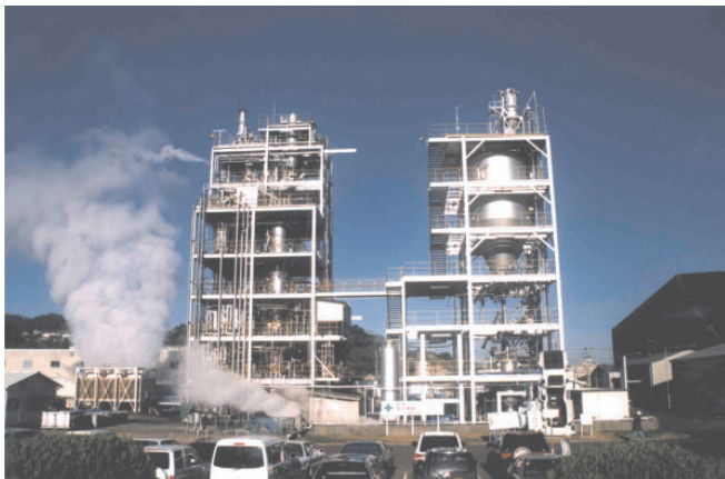
50TPD炉試験設備
