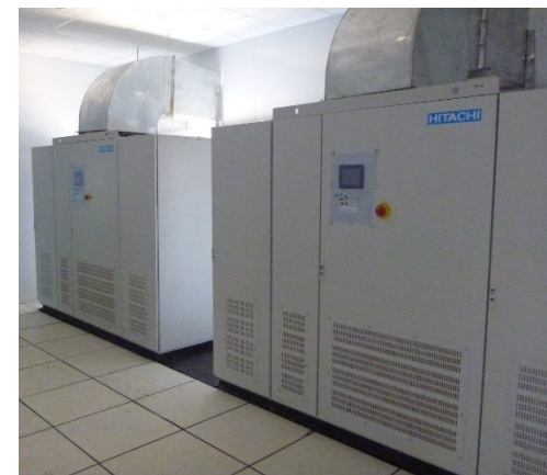
PCS設置状況
