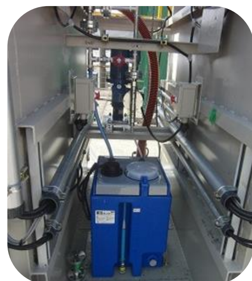
凝結遅延剤 添加装置
