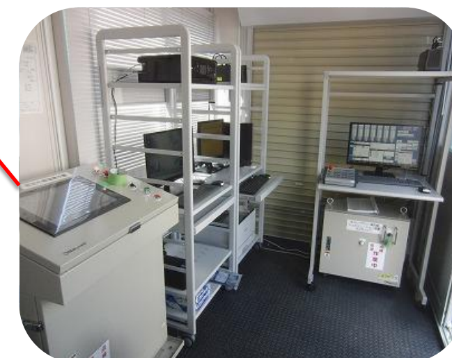
凝結遅延剤添加管理 装置セメント置換演算・ ミュレーション装置
