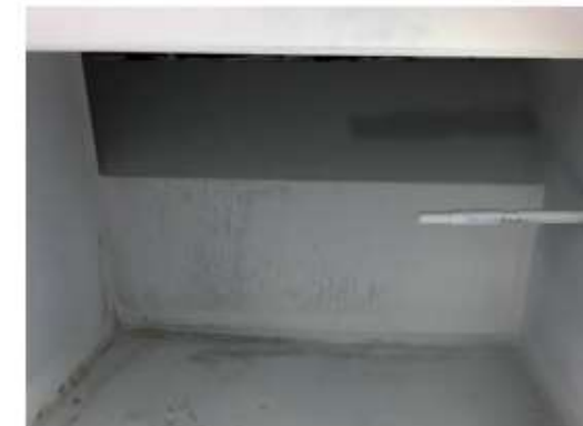
定置型用蓄熱槽
