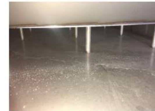
オフライン熱輸送用蓄熱槽
