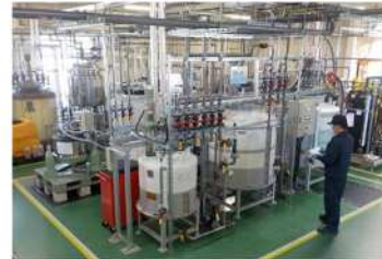
電解液パイロットプラント
