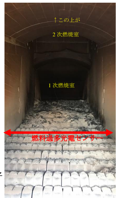
図 2.2.43 バイオマス熱風炉内部の様子
