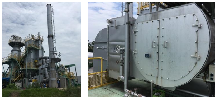
図 2.4.21 JFE 環境サービスの燃焼設備全景 (左)、ボイラー (エコマイザー側) (右)
