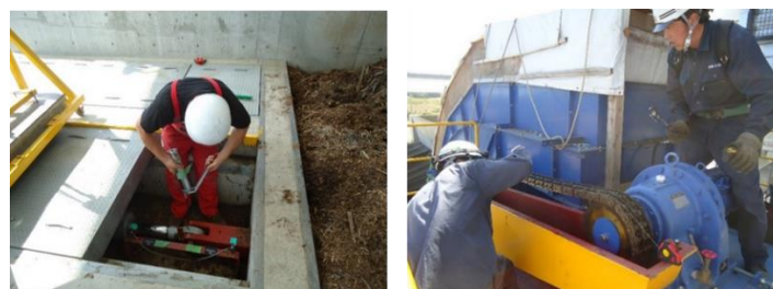
図 2.4.32 燃料搬送設備のメンテナンス状況
