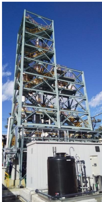
CO 2 分離・回収設備
