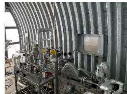
2020年度に設置した高压水素酸素供給設備
