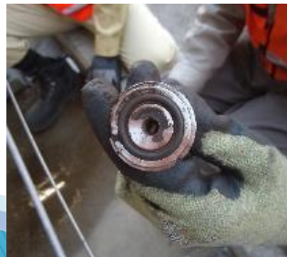
微粉炭搬送管（Ejector出口）に詰まった木質粒子
