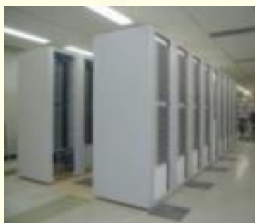
データセンター
