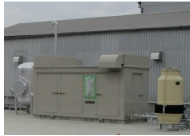
都市ガス圧縮機
