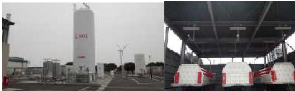
(a)LNG/N 2 供給設備
