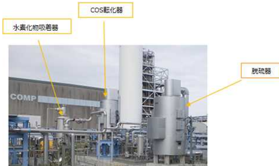
図 3-2-2-29 燃料電池用ガス精製設備
