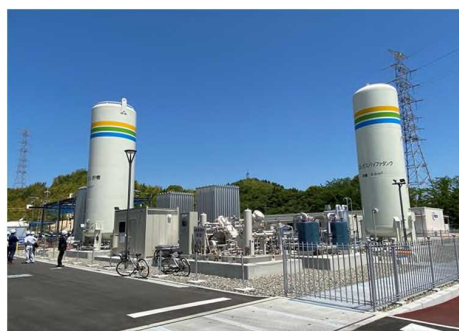
【A-1】CO 2 供給設備
