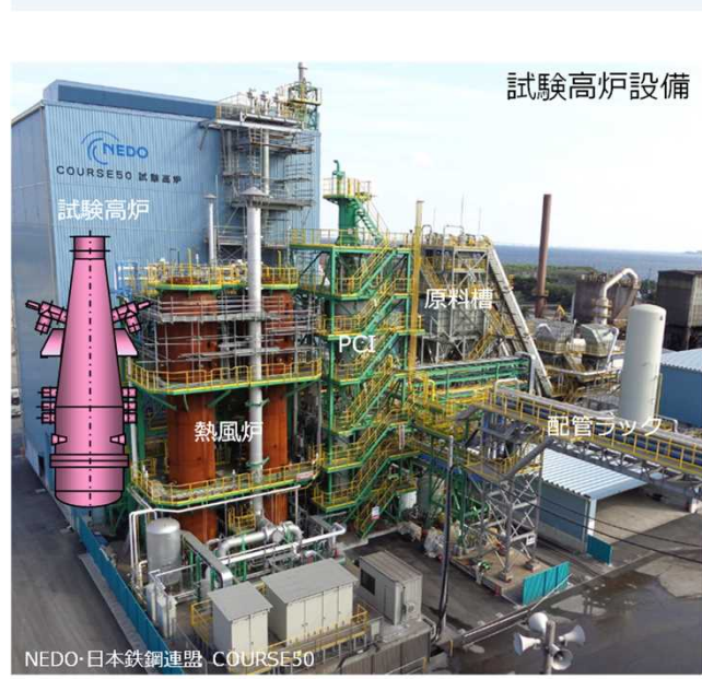
【試験高炉設備外観】
