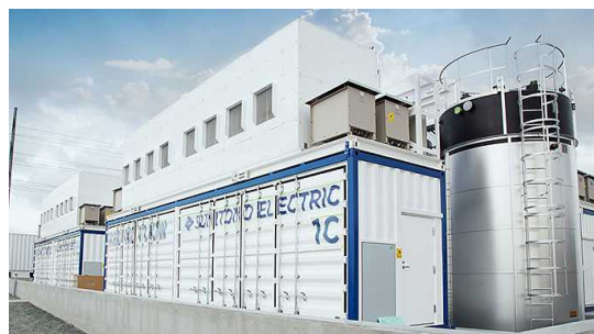
設置されたレドックスフロー電池
