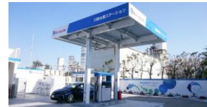
③水素ステーション (圧縮機、充填ホース等)
