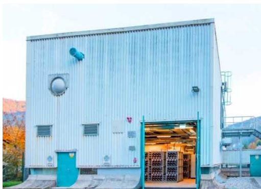
蓄電池システム設置箇所 (イドリヤ市)
