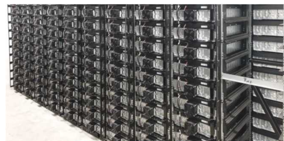
BTC向け蓄電池システム(リチウムイオン電池)
