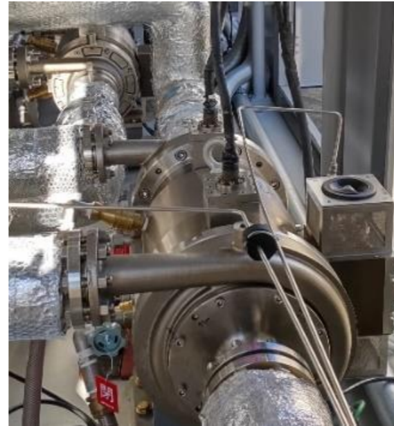
ユニット内部
