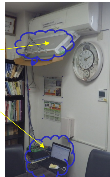
〔室内機・計測器設置全景〕
