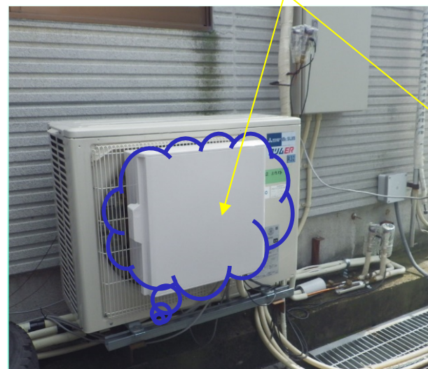
〔室外機設置全景〕
