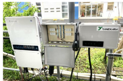
YaneBoxと災害時電源ボックス
