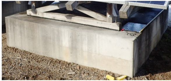
図 3-10 太陽光発電設備のコンクリートの置き基礎
