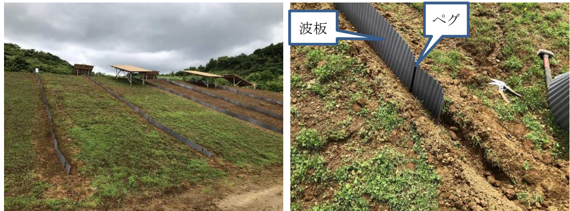
図 4-3 セパレータの設置状況
