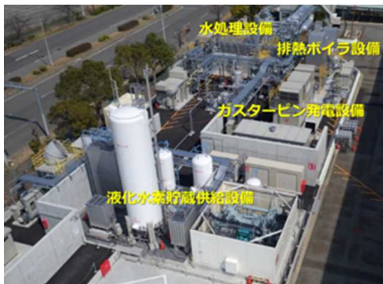
「神戸水素CGS実証設備」全景
