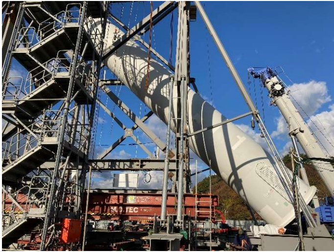
ボトムタワー (17.48m/21.682ton)
