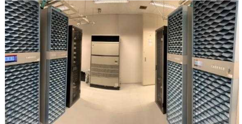
サーバ室(クラウド環境、エミュレータ)
