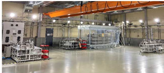
低圧大流量水素試験設備
