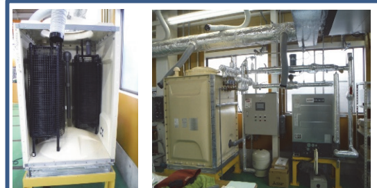
井戸水などの熱利用による空調
