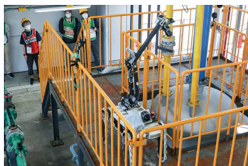
写真3 狭い空間でのバルブ操作
