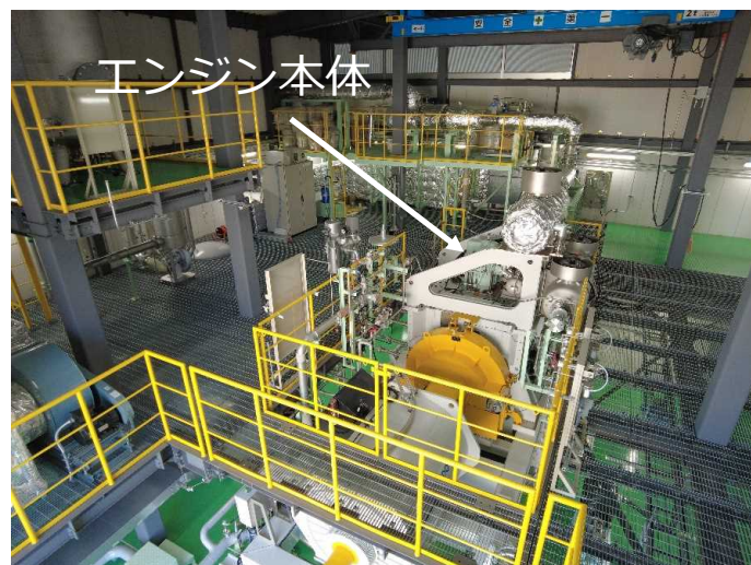
エンジンエンクロージャ内部
