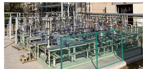
実圧燃焼試験用制御弁ユニット
