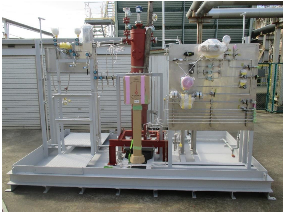
図 14 アンモニア供給装置の外観写真
