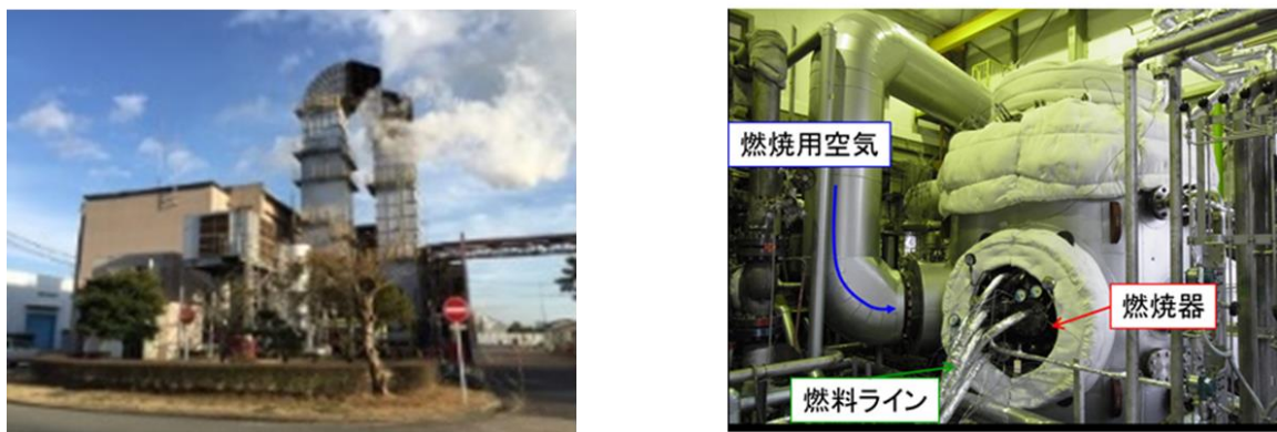
図 7 実圧燃焼試験設備および燃焼セル
