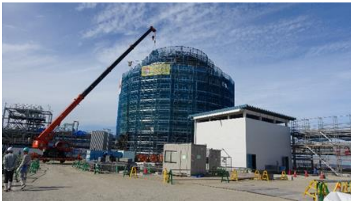
(a) 液化水素貯蔵タンク
