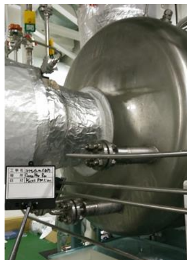
図 10 運転状態の気体水素圧縮機
