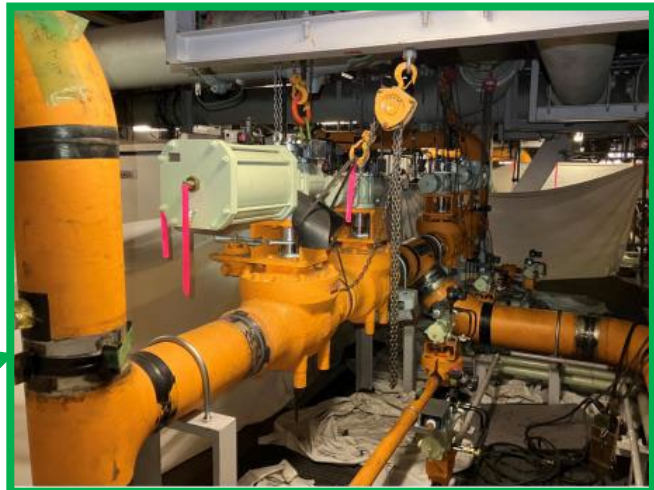
バーナ弁 廻り(ボイ ラ建屋内4 ~6FL)
