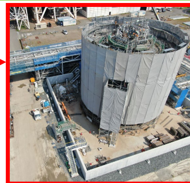
アンモニアタンク
