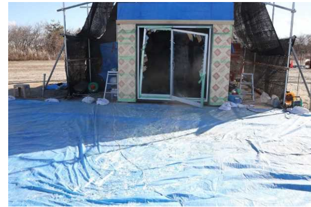
放出終了後の着火によって破損したガラス窓 (緩和が検討されている最大許容充填量)
